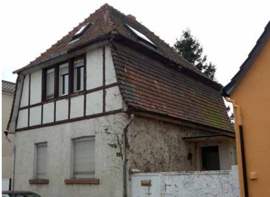
Das Haus vor der Sanierung: Die alten Dachziegel sind in die Jahre gekommen und machen optisch nicht mehr viel her.
