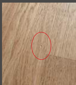
Boden mit Beschädigung
