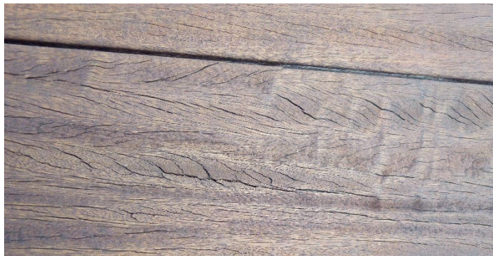
Starke Rissbildung durch zu schnelle Trocknung und falsche Behandlung mit Terrassenöl
