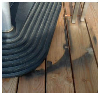
Verfärbung durch metallische Gegenstände
