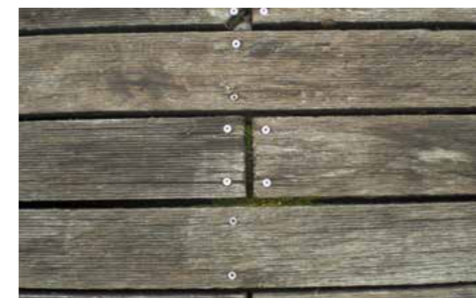
Moos und Dreck in den Fugen führt zur Pilzbildung und zum vorzeitigen Ausfall von Dielen.
