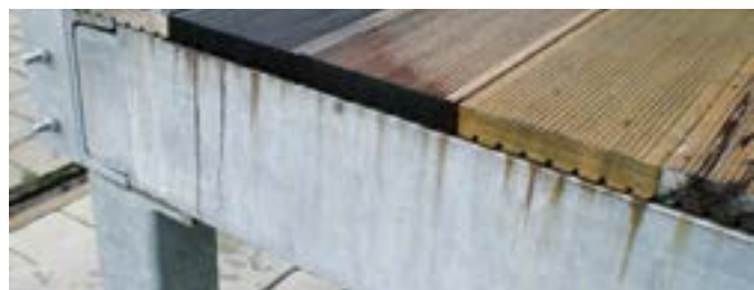
Auswaschungen aus Bangkirai, die sich nur durch eine konstruktive Lösung verhindern lassen.
