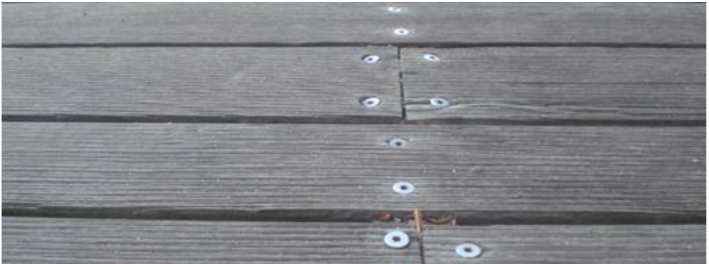
So sollte ein Schraubenbild nicht aussehen. Die Schrauben sind nicht in einer Flucht geschraubt.
