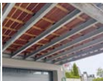
Beläge auf Stahlkonstruktionen
