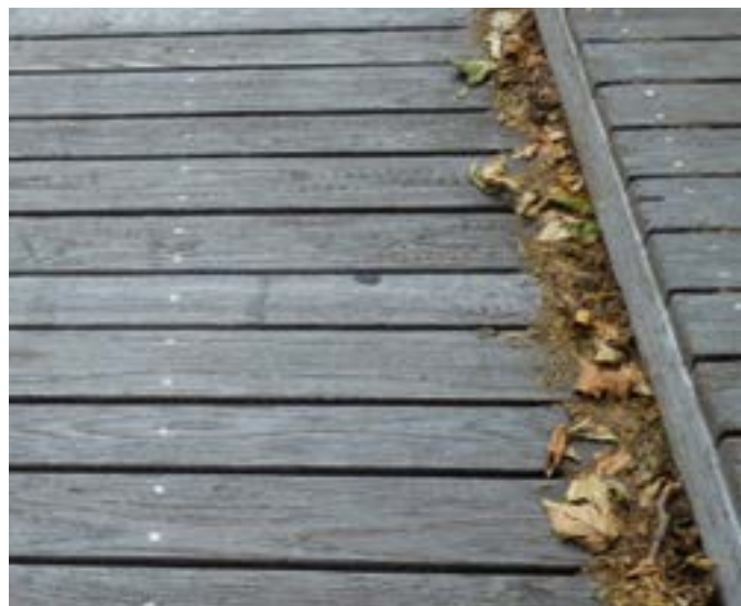
Laub und Schmutz muss aus den Fugen entfernt werden, damit keine Pilze entstehen können.
