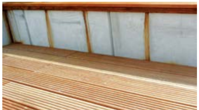
Auswaschungen können Sichtbeton und Putzfassaden verfärben und sind nur aufwendig zu beseitigen.
