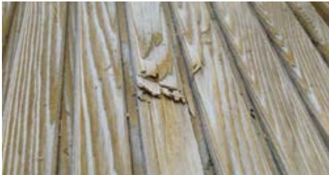
Ringschäle und Schilferrissen können auf der rechten Seite der Dielen entstehen.
